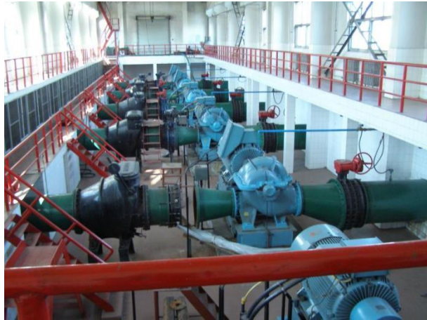
水厂泵站。图片来源：姚福来
